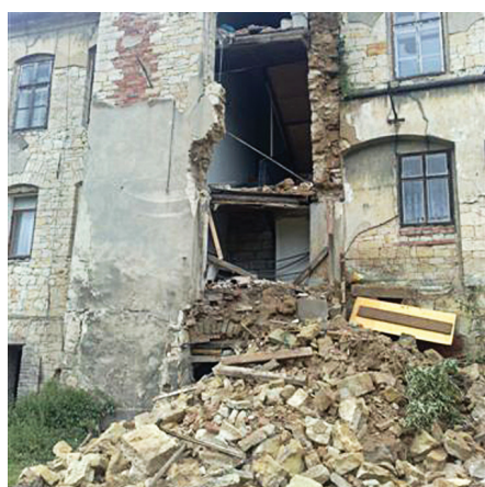
Zřícená část domu čp. 26.
